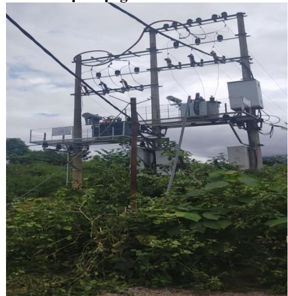
Ảnh 4: Trạm biến áp
