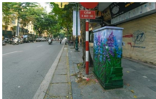
Giải pháp trang trí trụ điện trên vỉa hè
