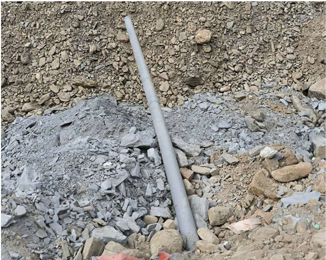
Hình 3.10. Hình ảnh về ống thoát nước thải sinh hoạt sau xử lý từ bể sinh học đến suối Nậm Cuối
