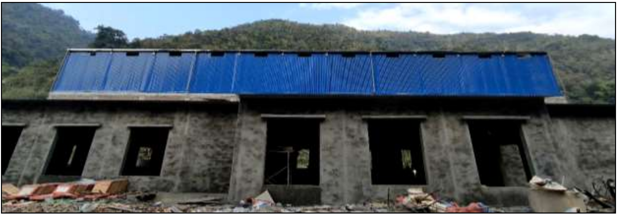
Máng thu và ống thoát nước mái nhà máy
