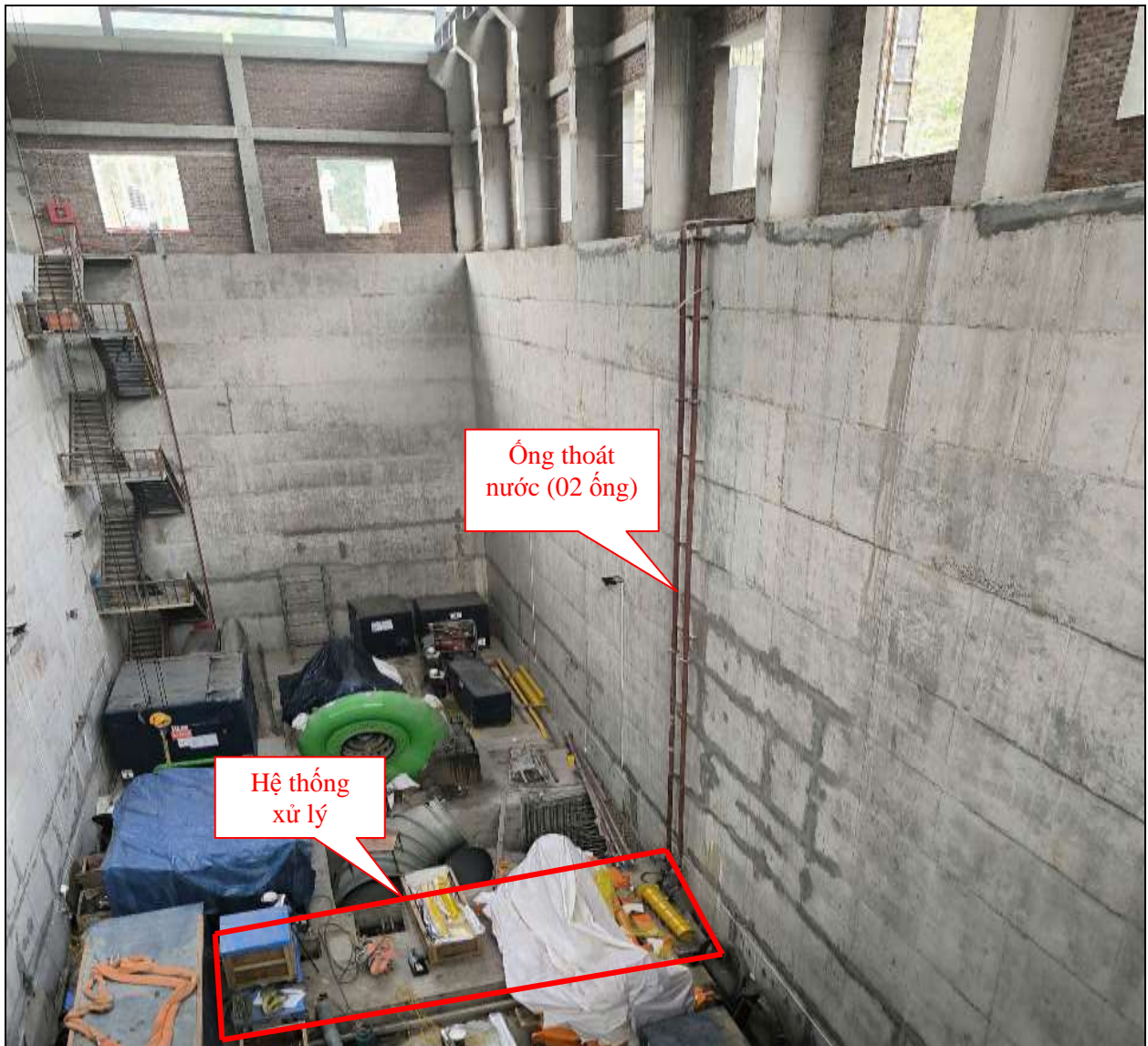
Hình 3.13. Hình ảnh về hệ thống xử lý nước thải nhiễm dầu và ống thoát nước ra bể xả hạ lưu nhà máy
