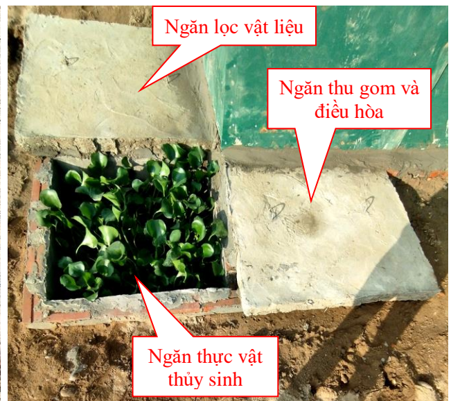
Bể xử lý sinh học
