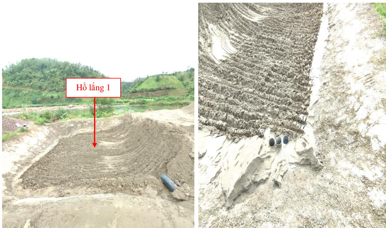
Ống chính dẫn nước vào hồ lắng 1
