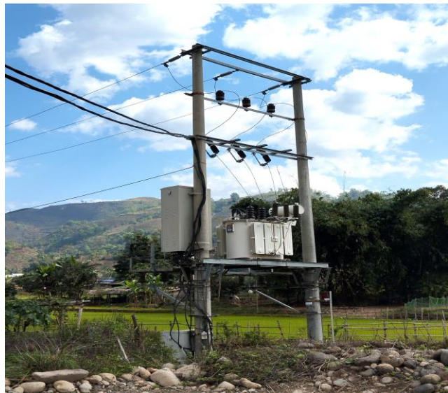
Trạm biến áp 560kVA-35/0,4kV
