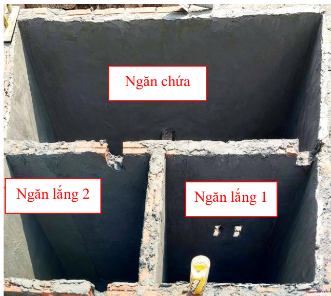
Bể tự hoại
