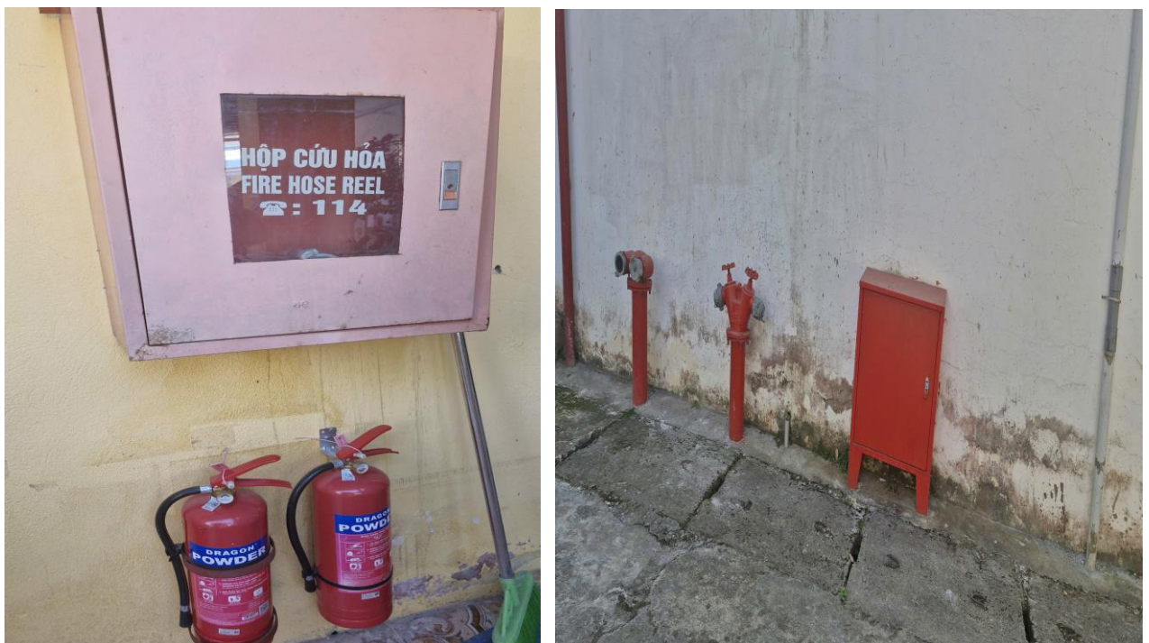
Hình 3.10. Các phương tiện, thiết bị chữa cháy hiện hữu tại cơ sở
