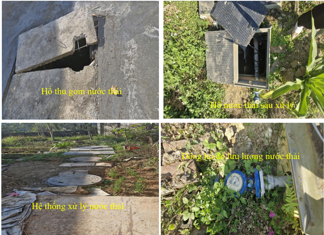
Hình 3.5. Một số hình ảnh hệ thống xử lý nước thải của cơ sở
