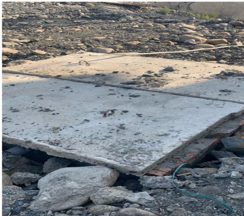
Hình 8: Bể tự hoại 3 ngăn khu nhà máy
