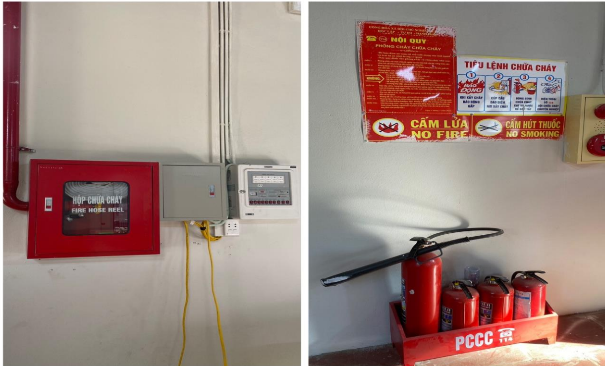
Hình 16: Thiết bị phòng cháy chữa cháy tại dự án
