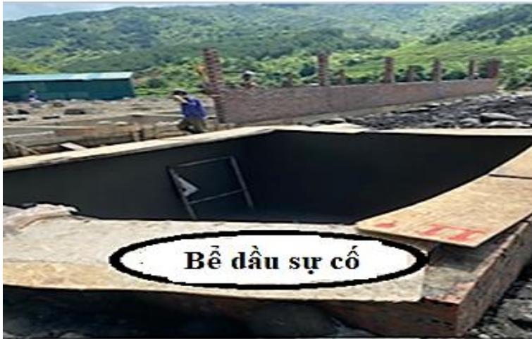
Hình 11: Bể dầu sự cố khu vực TBA
