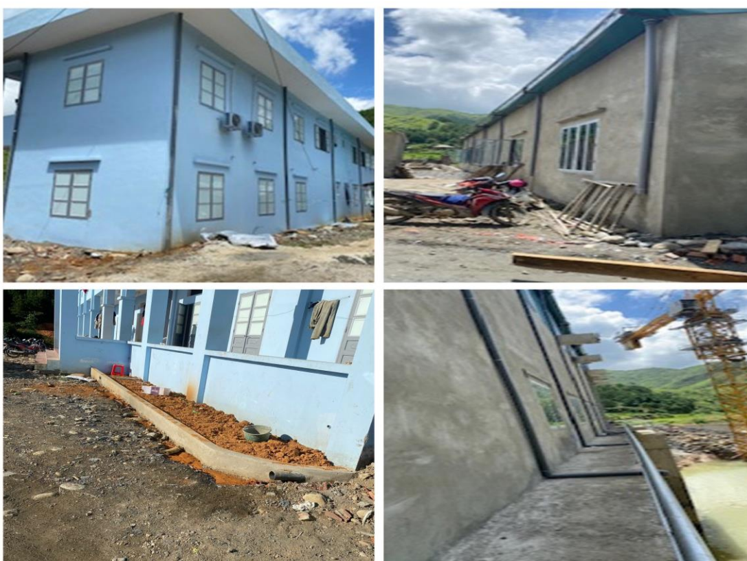
Hình 5: Hệ thống thu gom, thoát nước mưa khu nhà điều hành - nhà máy
