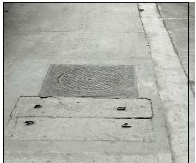
Cống D600mm và hố ga thoát nước mưa ngoài nhà
