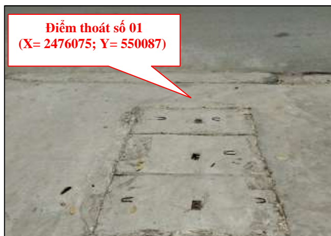
Điểm thoát số 01 ra hệ thống thoát nước chung của thành phố dọc đường Triệu Quang Phục
