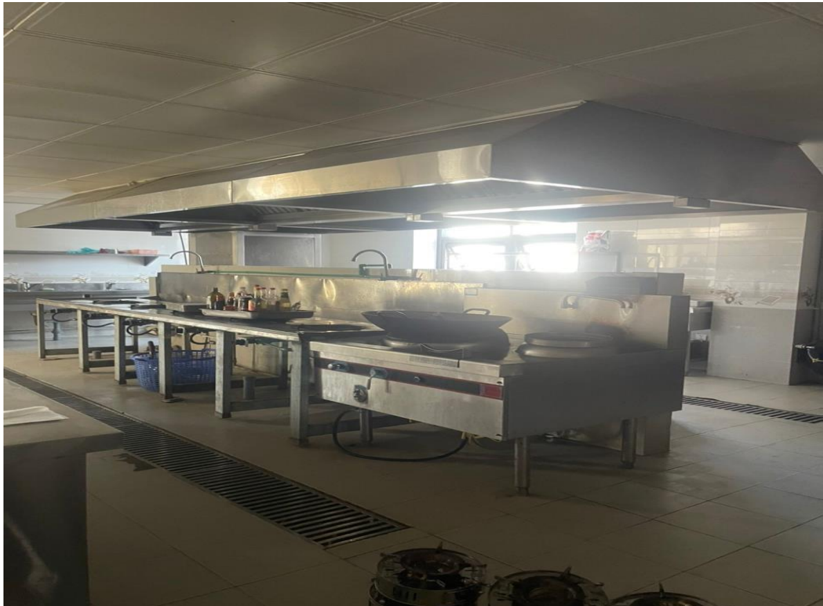
Hình 15: Hệ thống hút mùi khu vực nấu ăn
