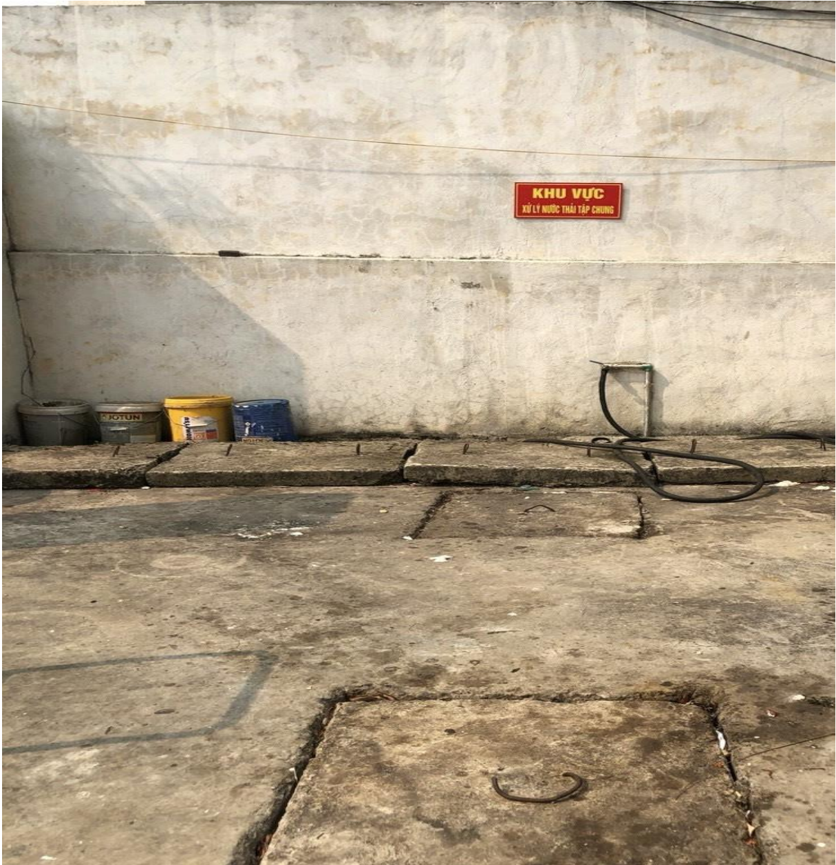
Hình 14. Hình ảnh hệ thống nước thải tập trung
