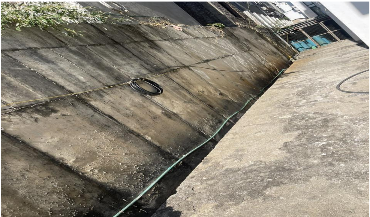
Hình 8: Rãnh thu gom, thoát nước thải của cơ sở
